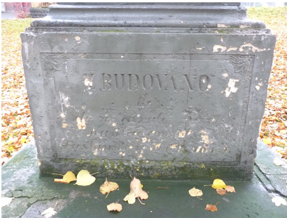
Podstavec nevhodně natřený barvou.
