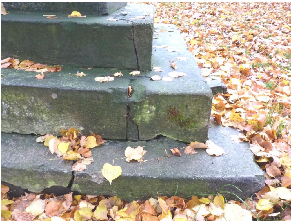
Detail poškození schodového stupně.
