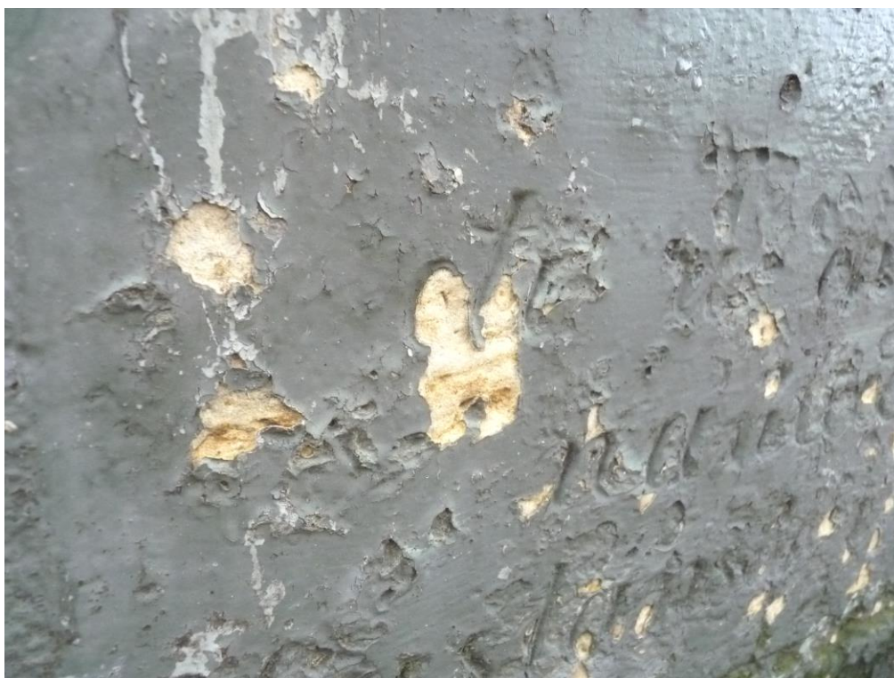
Detail poškození kamene vlivem nevhodného nátěru.
